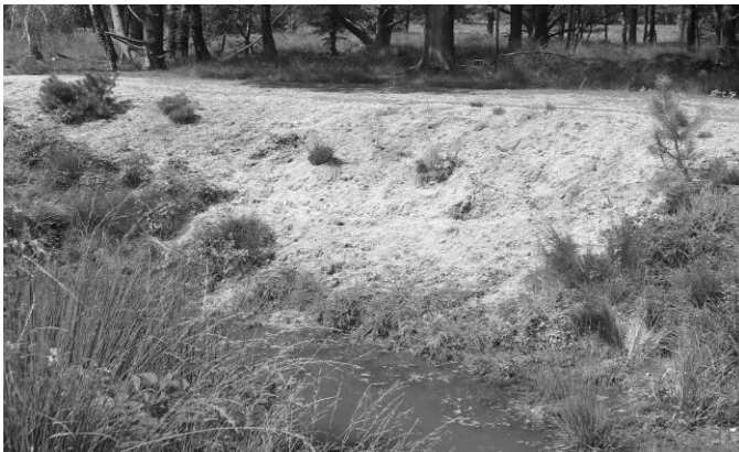
Figuur 2. Erosie van talud Heelsumse beek
