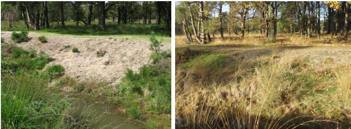
Figuur 3.11 Erosie op talud in 2011 (links) en 2017 (rechts). Foto's: Herman Thunnissen.
